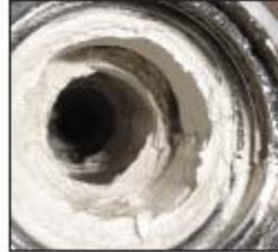
Acumulación de depósitos de azufre en líneas de flujo.
